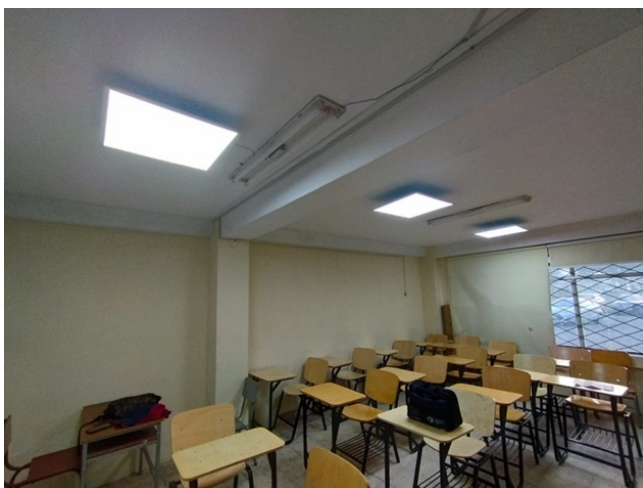
Fig. 15: Disposición de las luminarias LED dimerizables.
