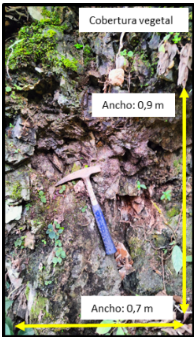
Fig. 11: Afloramiento de caliza con presencia de varias fracturas en donde hay filtración de agua
